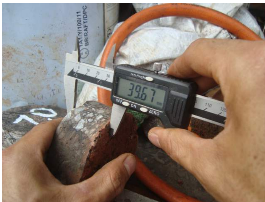
Figura 4 – Espessura da CBUQ (3,97 cm) em quantidade inferior à contratada (5,0 cm)
