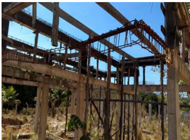
Figura 8 – Perda parcial da ferragem e estrutura em virtude da paralisação da obra
