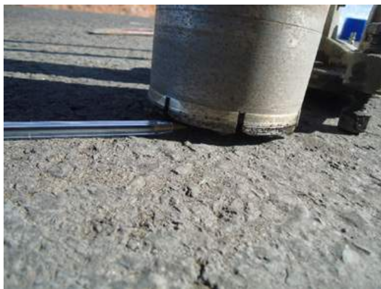
Figura 23 – Amostras retiradas desalinhadas.
