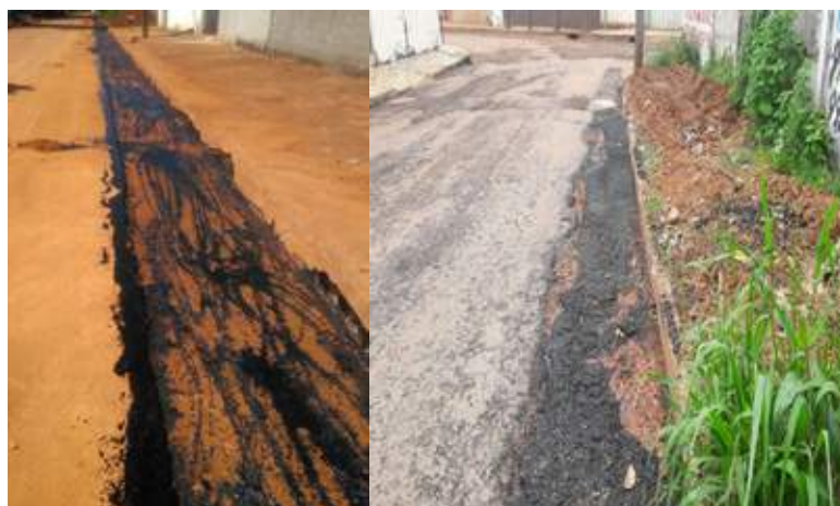
Figura 8 – má aplicação de material selante e capa asfáltica
