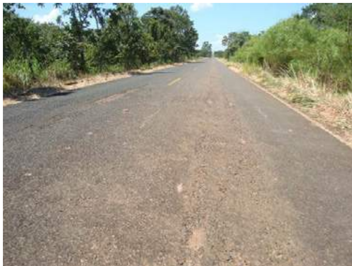
Figura 6 – Desgaste prematuro do pavimento executado em Tratamento Superficial Duplo
