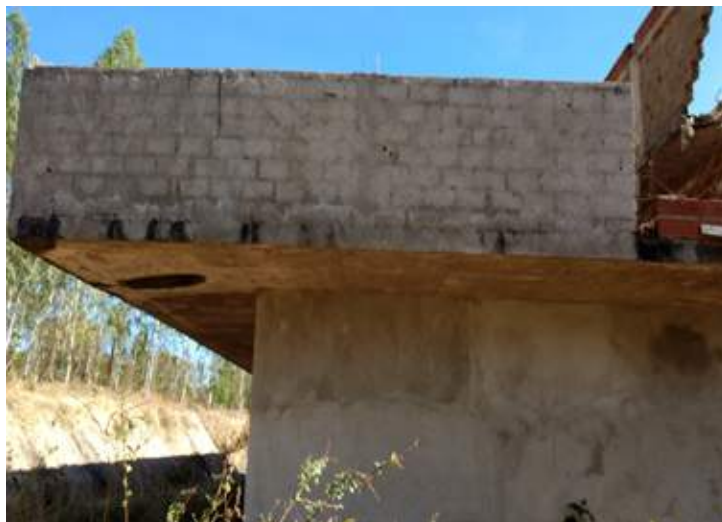
Figura 7 – Alvenaria com risco de colapso
