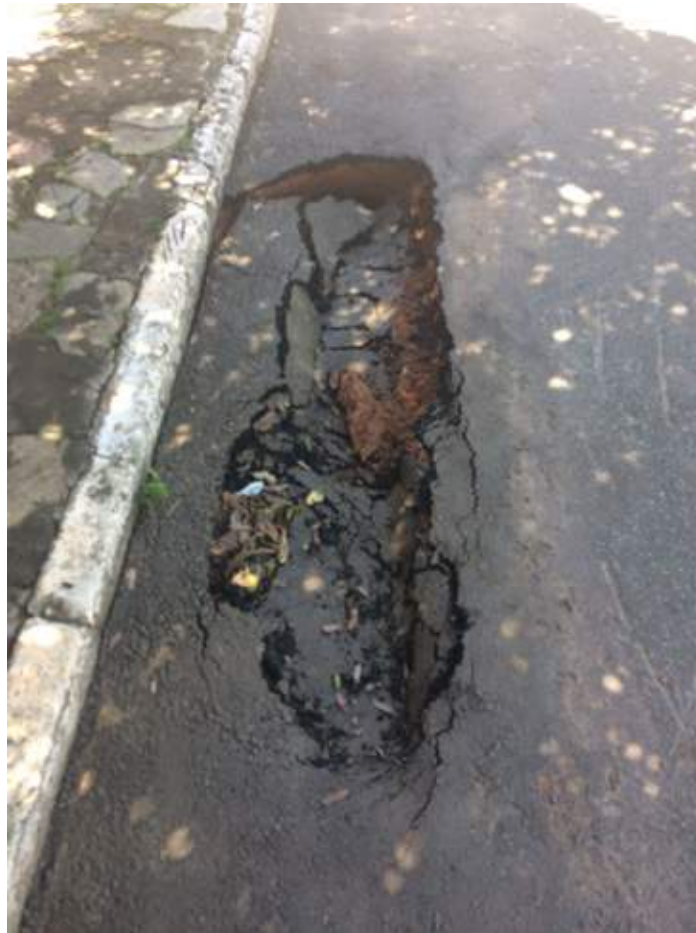
Figura 7 – recalque do solo devido má compactação.
